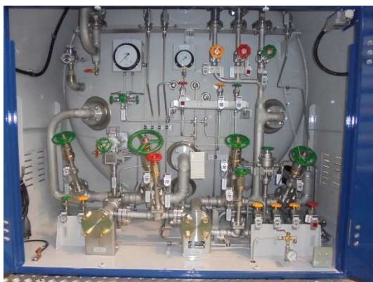
トレーラー バルブBOX内
