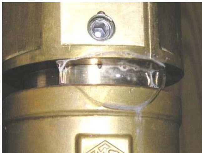
写真9 漏れ量が少ない状態
