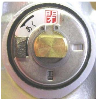
写真4 安全弁元弁「閉」の状態
