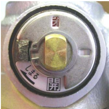
写真2 安全弁元弁「開」の状態
