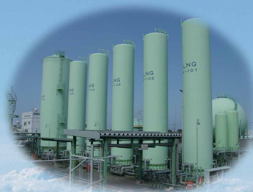
■ LNGサテライト設備 LNG SATELITE EQUIPMENT
